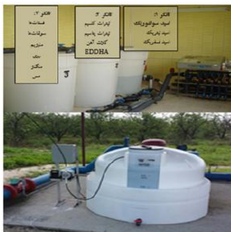
شکل ۳ تانکر ویژه تزریق اسید سولفوریک در سیستم‌های آبیاری تحت فشار به همراه پمپ تزریق مخصوص اسید
