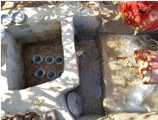
شکل ۸- وضعیت نصب و استقرار لوله‌های زیرسطحی پی‌وی‌سی در کنار درختان پسته (شکل الف) و در ردیف‌ها (شکل ب).
