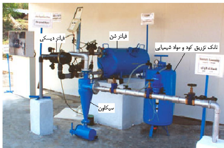
شکل (۲) - نمونه ای از یک سیستم تصفیه آب در سیستمهای خرد آبیاری
