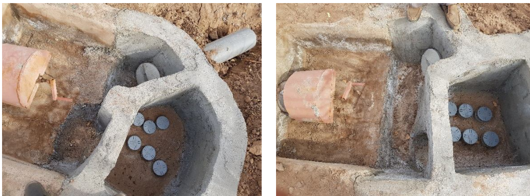
شکل ۱۱- نحوه استقرار مناسب (راست) و نامناسب (چپ) لوله‌ها در داخل حوضچه‌های آبیاری
